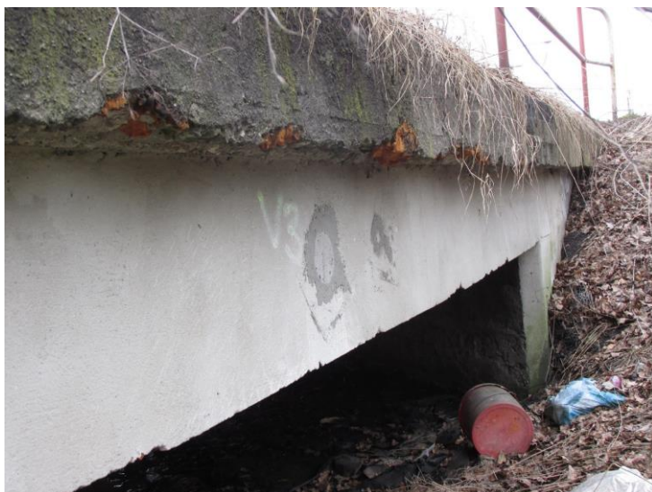
Pohled na pravou římsu – rozpad povrchu betonu, odlámané hrany, vegetace na římsě.
