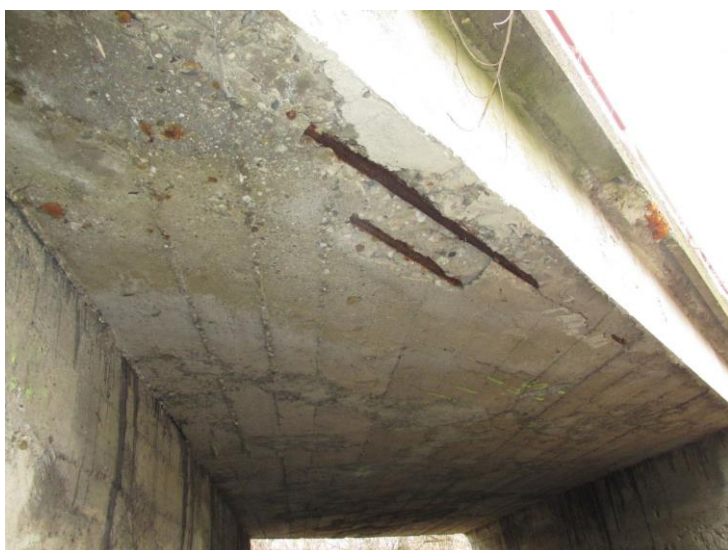
Podhled NK zleva - u opěry OP2 odhalená korodující výztuž.
