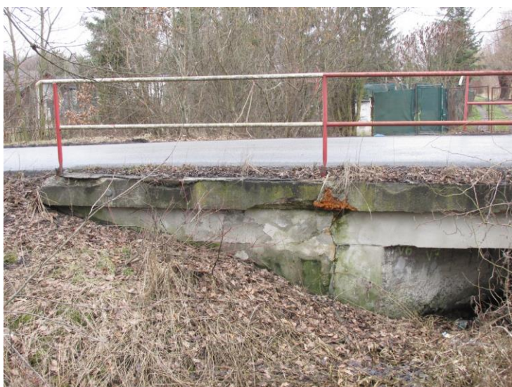
Pravé křídlo opěry OP1 – výluh a místy odpadávající omítka, zavlhlá otevřená spára mezi křídlem a opěrou.
