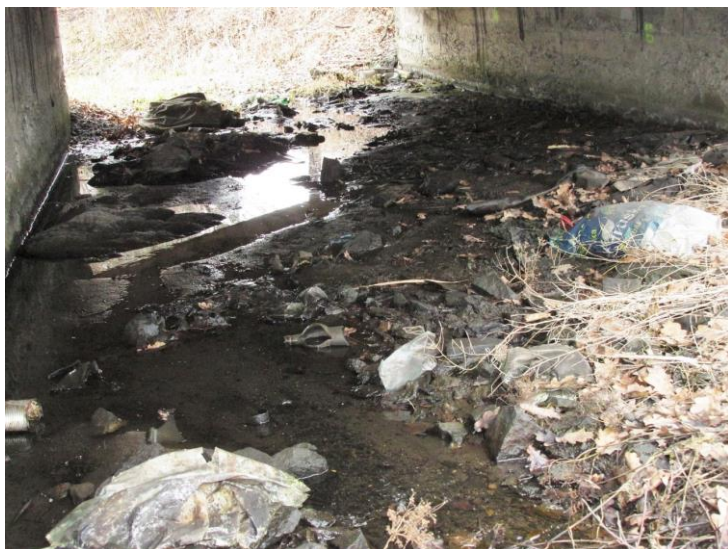
Pohled zprava na koryto toku zanesené naplaveninami, vegetací a nečistotami.
