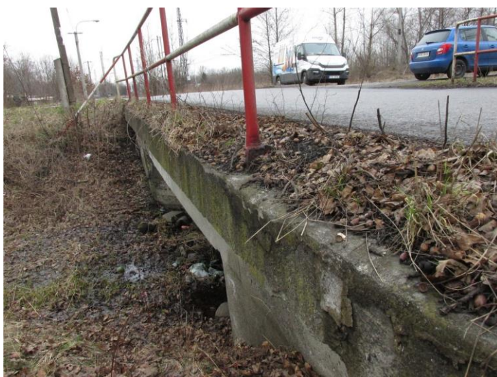
Římsy - rozpad omítky a povrchu betonu, vegetace a nečistoty na římsách, vozovka převýšena nad římsy – zde levá římsa.
