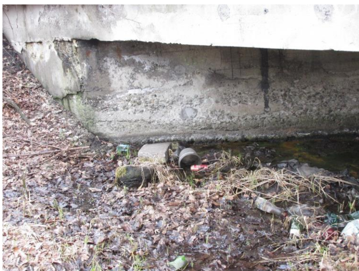
Opěra OP2 vlevo – degradace povrchu betonu, rozpad povrchu betonu boku opěry a křídla.
