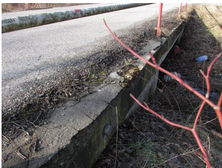
Římsy - rozpad omítky a povrchu betonu, vegetace a nečistoty na římsách, vozovka převýšena nad římsy – zde pravá římsa.
