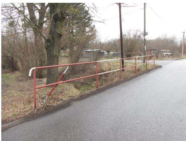
Zábradlí nevyhovuje požadavkům ČSN – zde levá strana.
