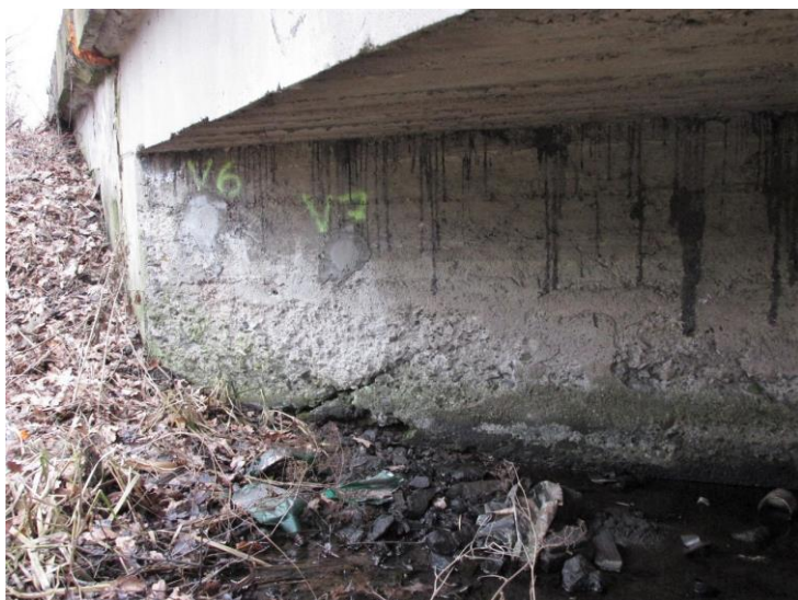
Opěra OP1 vpravo – místně degradace povrchu betonu líce, kaverna v dolní části, sanace po provedených vývrtech.
