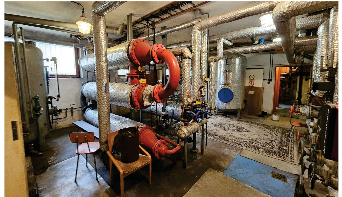
Pohled na výměňikovou stanici objektu
