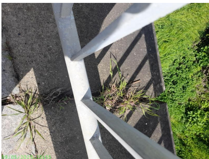
Dilatační spáry chybějící tmelení římse, vegetace,
