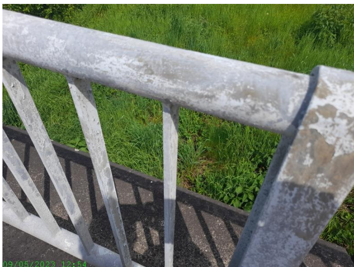
Degradace nátěru zábradelního svodidla
