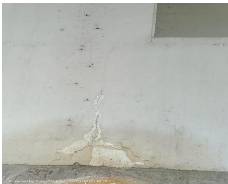
Trhlina v líci dříku OP2 vlevo.
