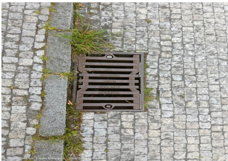
Vegetace zakořeněná ve spárách a povrchová koroze odvodňovací vpusti.
