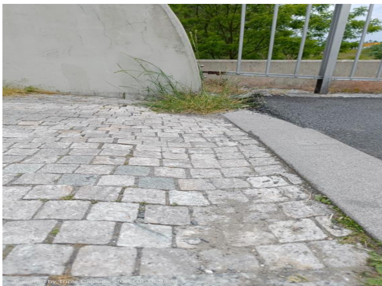
Propad za OP2 v dlažbě a pokles kamenné obruby v přechodové oblasti.
