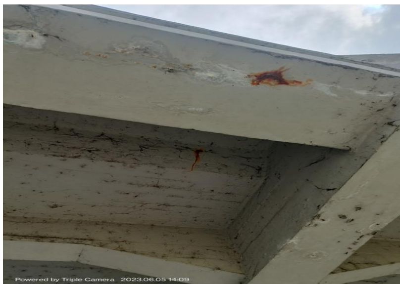
Příklad trhliny v podélném trámu s výluhy a korozi výztuže.
