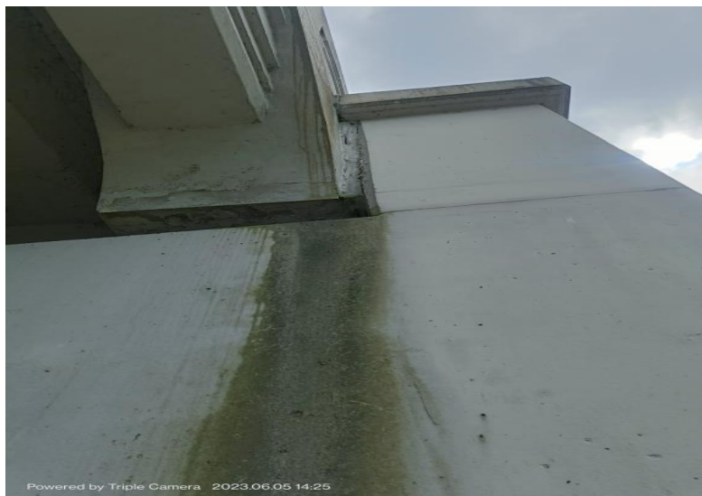
Potečení OP2, pravá strana, zatéká na ÚP mezi římsou křídla a NK.
