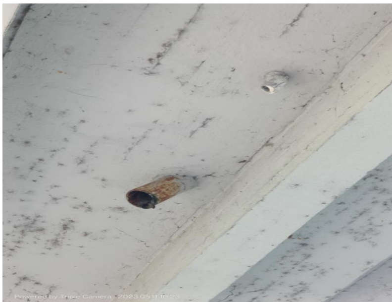
Inkrustace na svodu odvodňovače.
