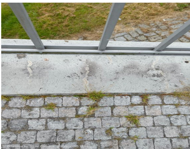
Trhliny v římse, cca. 3 - 4 ks pole mezi sloupky zábradlí, šíře do 0,7mm.
