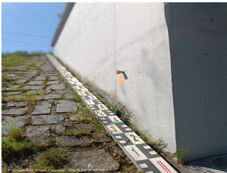
Vodoměrná lať a nivelační značka na opěře OP2 vlevo, prorůst vegetace kamennou dlažbou.
