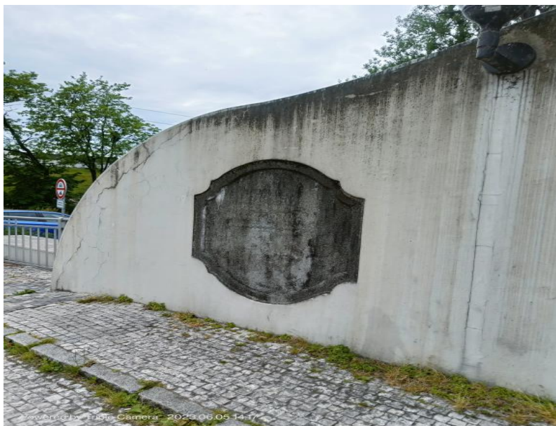
Koncový blok oblouku, opěra 2 vpravo, plošné trhlinky, prorůst vegetace.
