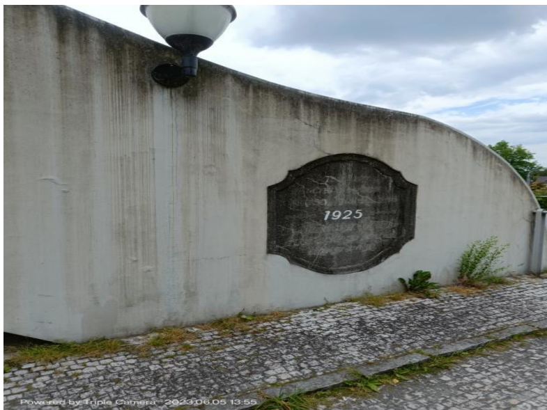
plošné trhlíčky, prorůst vegetace.
