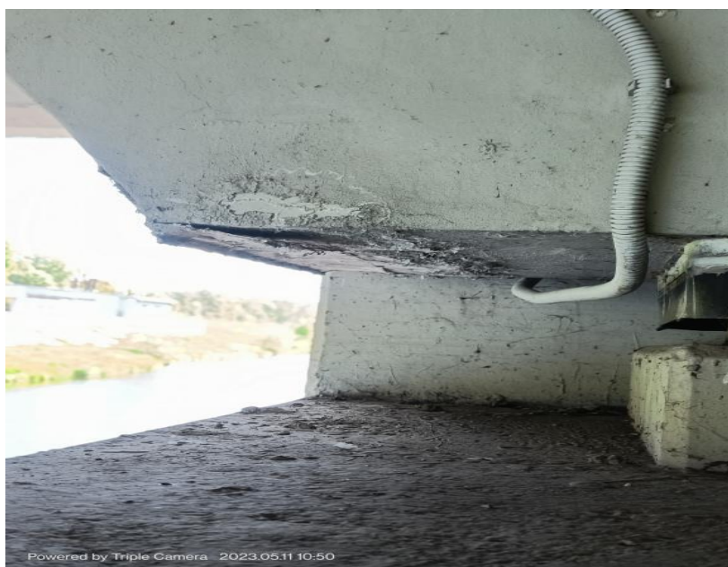
Levá část příčniku OP2, degradující sanace cizí zařízení.
