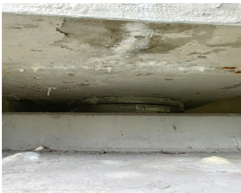
Levé ložisko OP1, potečení, degradace provedených sanací a inkrustace.
