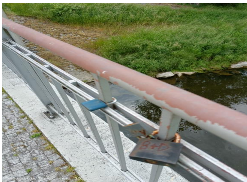
Poškozené PKO horního madla zábradlí, přimykání visacích zámků na zábradlí.
