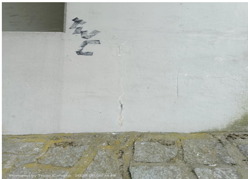
Trhlina v líci dříku OP2 vpravo.
