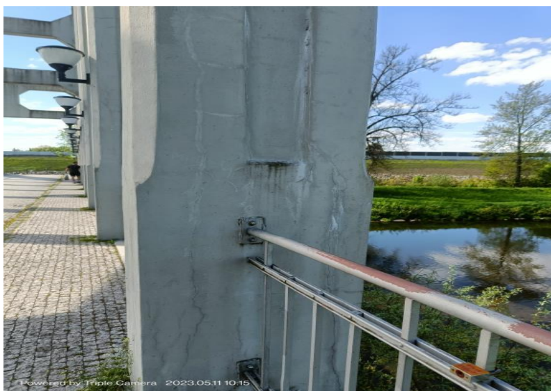
Táhlo vpravo, výluhy, svislé trhliny.
