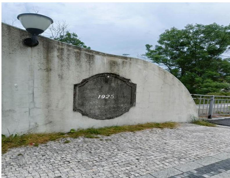
Koncový blok oblouku, opěra 2 vlevo, plošné trhlínky, prorůst vegetace.
