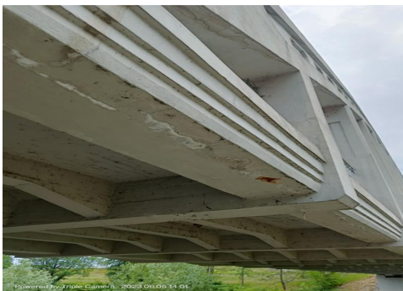
Pohled na boční stranu mostu, pravý hlavní trám, výluhy, podélné trhliny.
