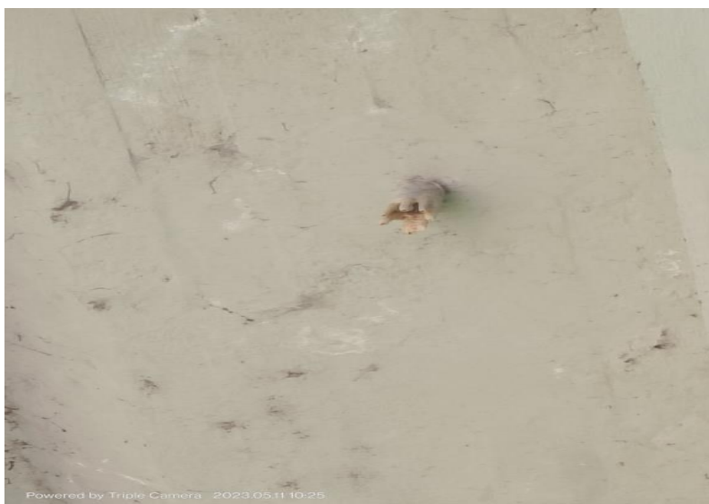
Inkrustace na odvodňovací trubičce.
