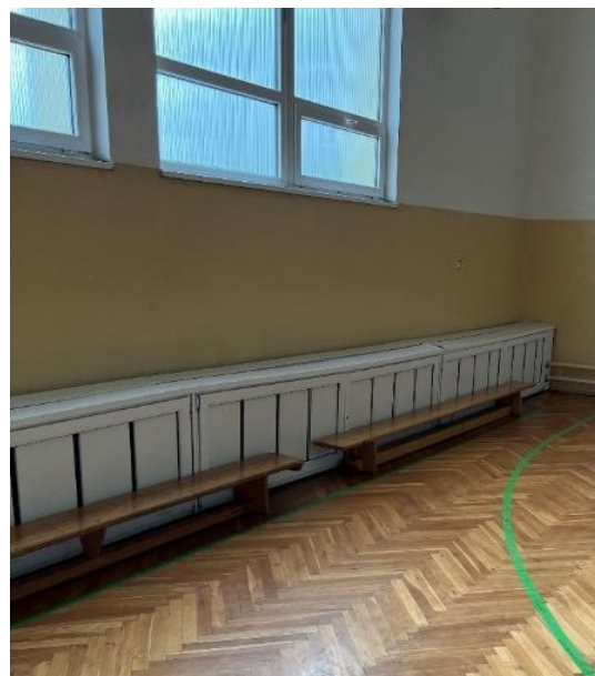
Obr. Detail OT v tělocvičně
