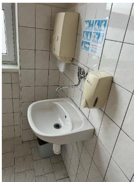
Obr. Detail výtokové armatury
