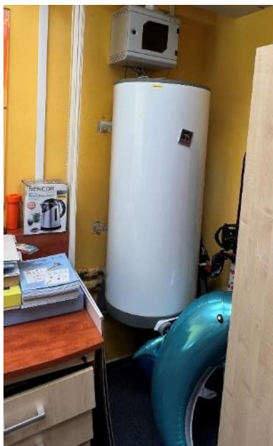
Obr. Elektrický bojler ohřevu teplé vody
